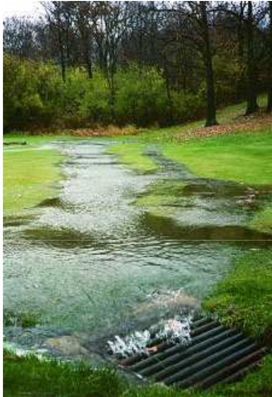
Lietus ūdeņu noplūde kanalizācijas šaftā
